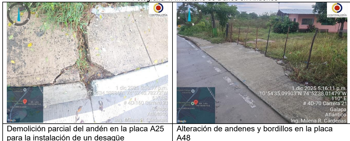
Fotografía 4. Inventario de Daños en Andenes
