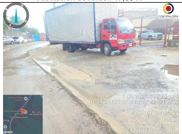
Afectación de Andén 47,85 m 2
