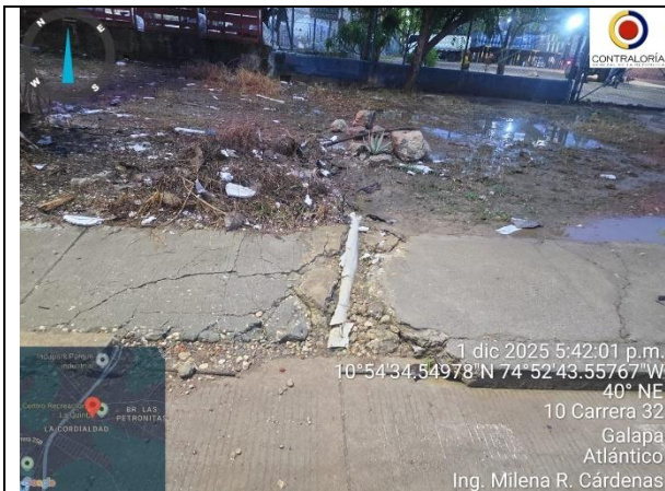
Afectación de Andén 47,85 m 2
