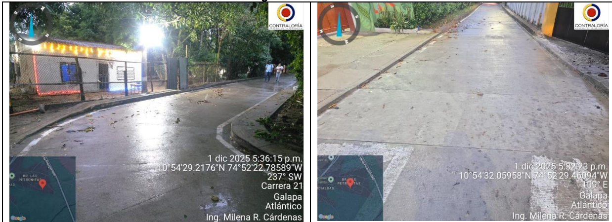
Condiciones generales de la vía
