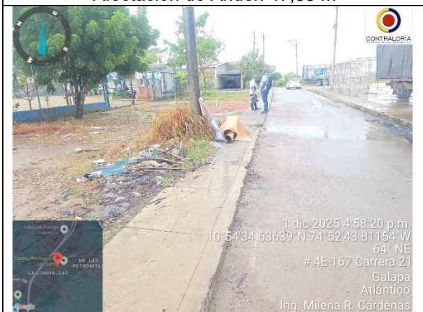
Afectación de Andén 47,85 m 2
