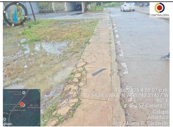
Afectación de Andén 47,85 m 2
