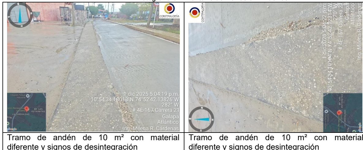
Fotografía 5. Inventario de Daños en Andenes
