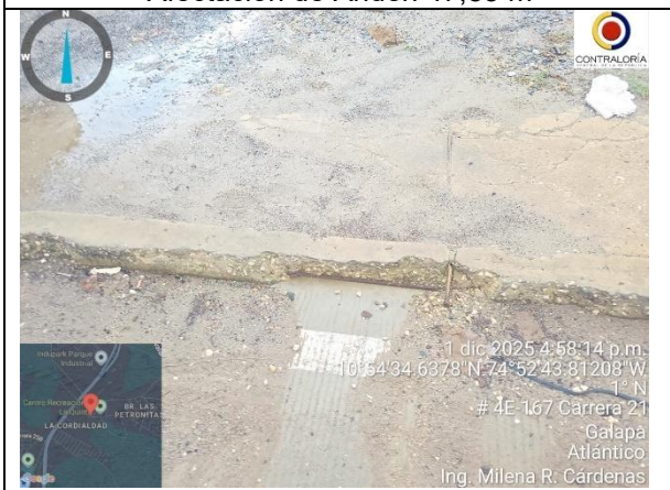
Afectación de Andén 47,85 m 2
