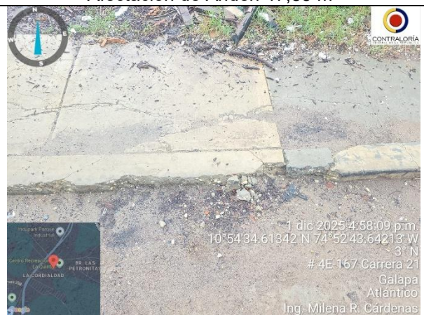
Afectación de Andén 47,85 m 2
